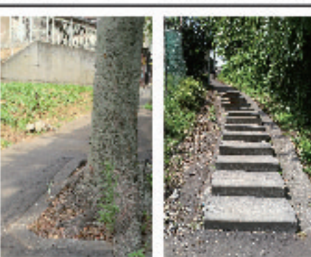
平尾はなぶさ幼稚園・セブンイレブン裏手の階段。劣化が激しく今後改修が必須。(写真右)街路樹の根上りでベビーカー、車いす等が通行する際に危険な平尾中央通り歩道(写真左)
